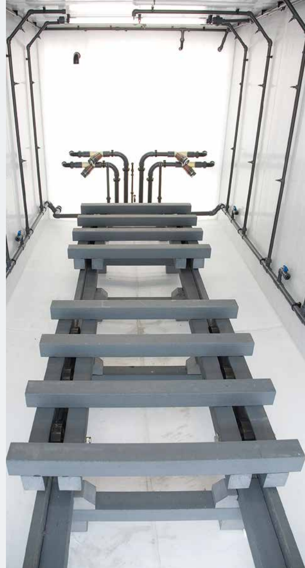
Tauch-Beisanlagen (ganz links) und eine Rotainer-Beisanlagen (rechts).
