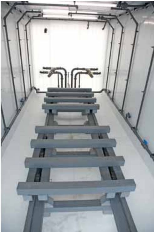
Abb. 1: Die hier beschriebene Beizanlage arbeitet abwasser- und emissionsfrei durch salpetersäurefreies Beizen im geschlossenen, rotierenden Sprühsystem (Alle Abbildungen: Siedentop GmbH)
